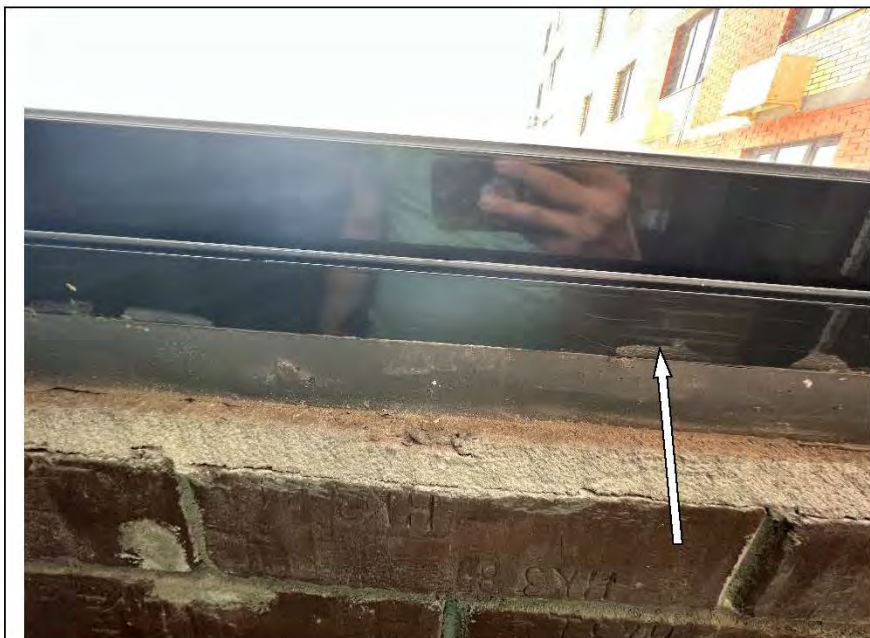
Фото №49. Царапины на металлическом профиле оконного блока на лоджии.
