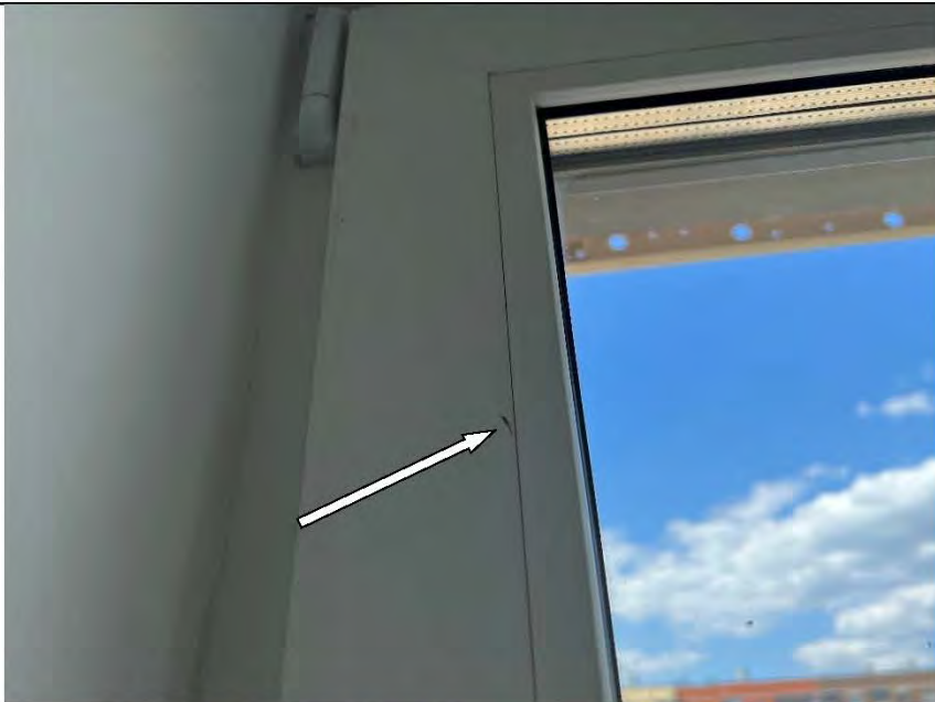
Фото №41. Царапина на профиле ПВХ оконного блока в спальне.
