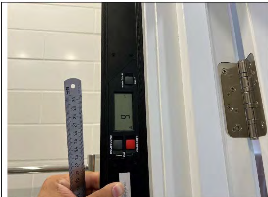
Фото №58. Отклонение наличников дверного блока в ванной комнате равно 6 мм.
