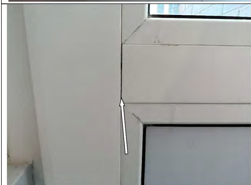
Фото №47. Зазоры в стыке профилей оконного блока ПВХ в гостиной.
