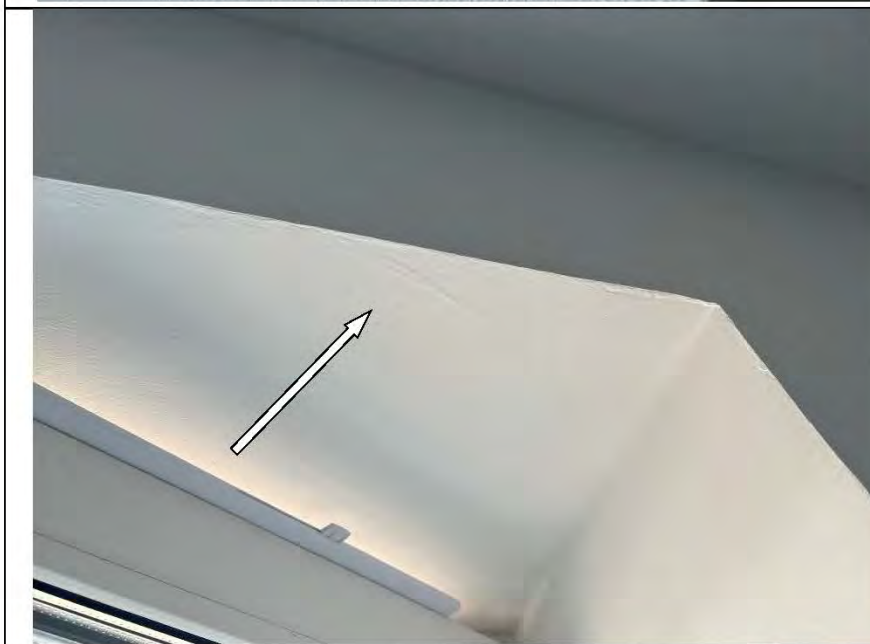
Фото №38. Подтеки краски на откосе оконного блока ПВХ в кухне.
