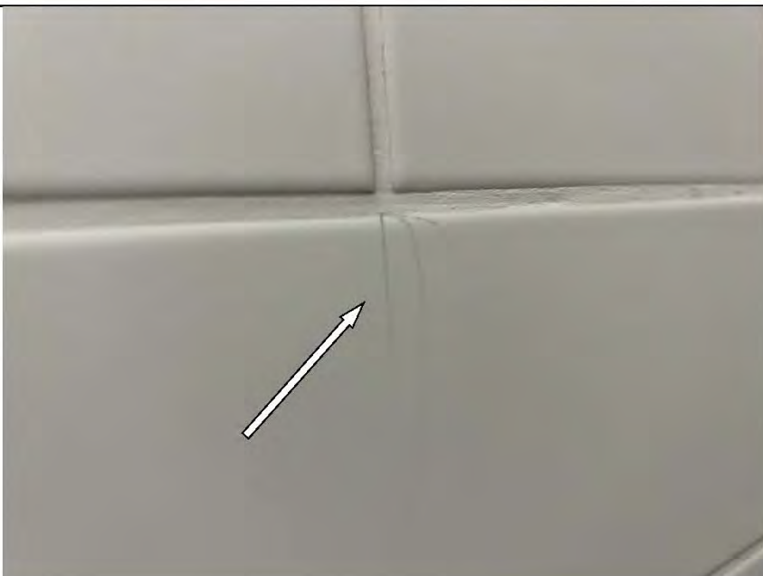
Фото №21. Наличие волосяных трещин на поверхности настенной плитки в санузле.
