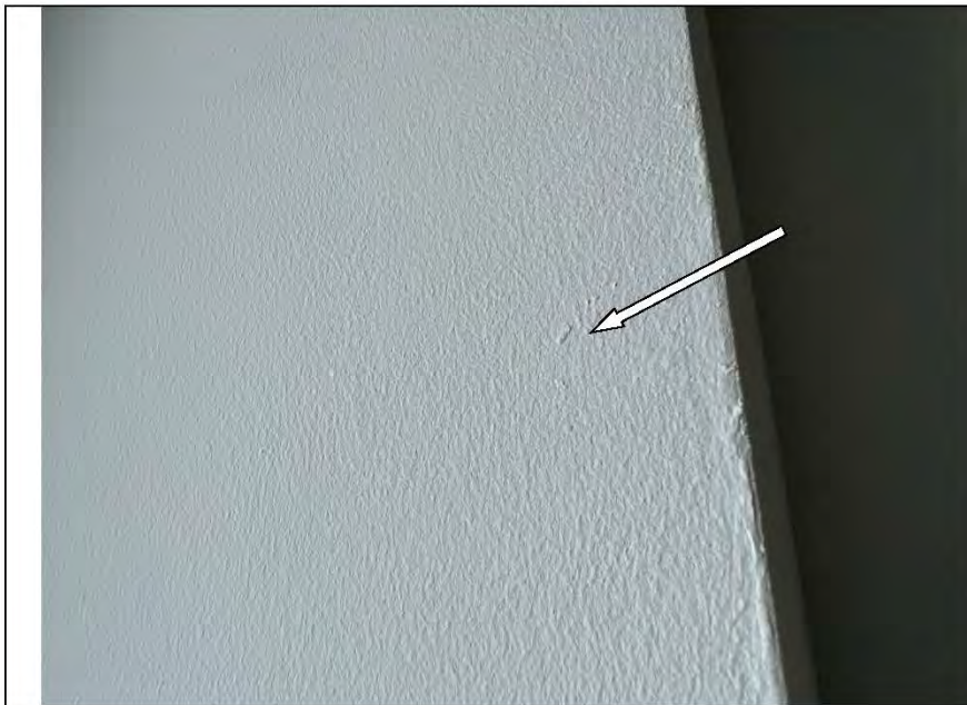
Фото №37. Подтеки краски на откосе оконного блока ПВХ в спальне.
