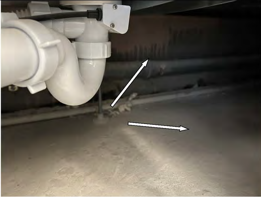
Фото №19. Частично отсутствует настенная и напольная плитка за ванной.
