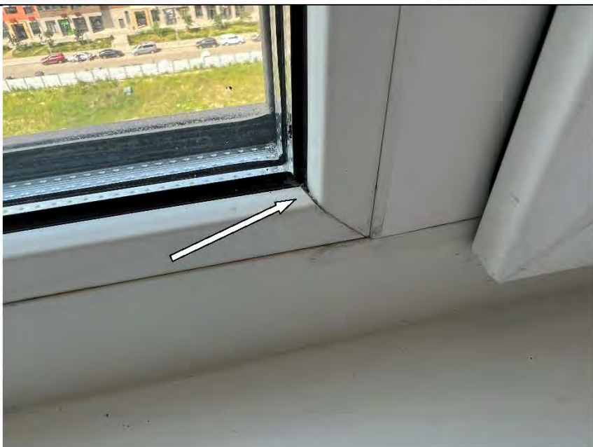
Фото №44. Зазоры в стыке профилей оконного блока ПВХ в спальне.
