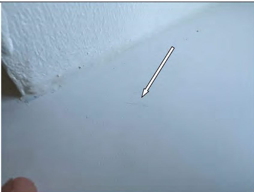
Фото №36. Царапина на лицевой поверхности подоконной доски в спальне.
