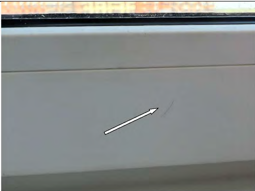
Фото №42. Царапина на профиле ПВХ оконного блока в спальне.
