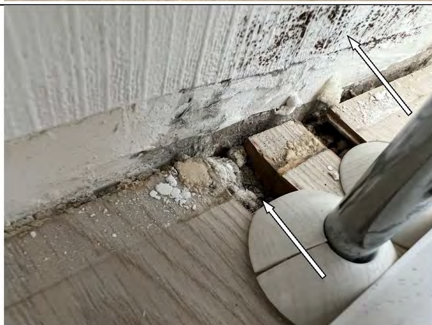
Фото №33. Видимые следы поражения грибком поверхности стен в спальне. Дефект заделки отверстия для трубопровода отопления в спальне.
