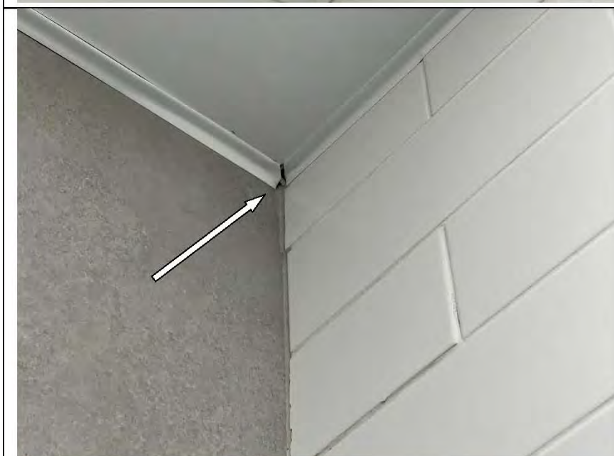
Фото №56. Дефект монтажа декоративного молдинга в санузле.
