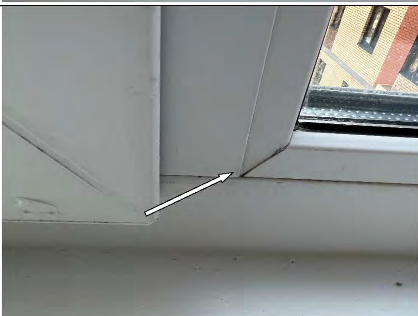
Фото №45. Зазоры в стыке профилей оконного блока ПВХ в кухне.
