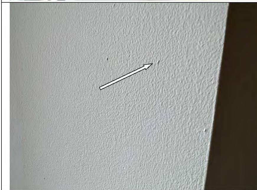
Фото №39. Подтеки краски на откосе оконного блока ПВХ в гостиной.
