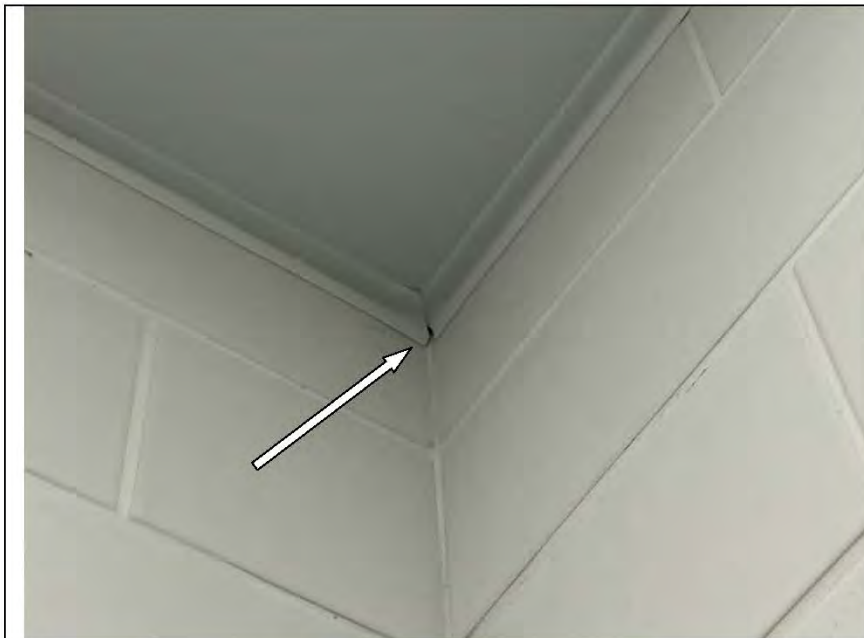
Фото №55. Дефект монтажа декоративного молдинга в ванной комнате.
