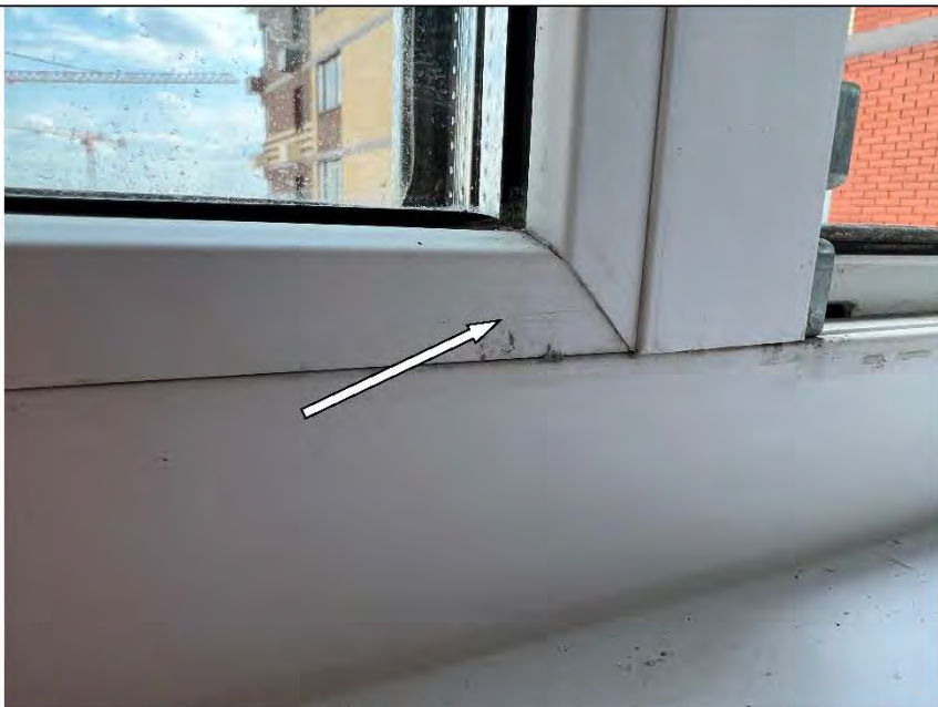
Фото №43. Царапина на профиле ПВХ оконного блока в кухне.
