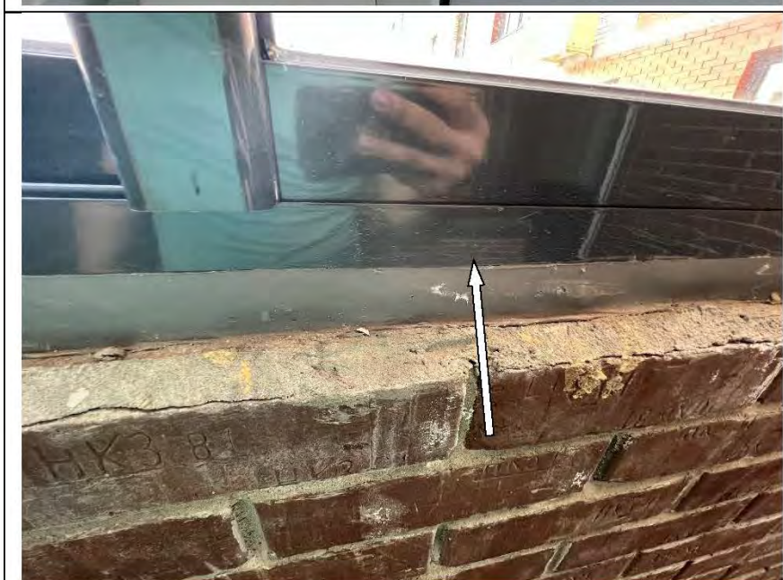
Фото №48. Царапины на металлическом профиле оконного блока на лоджии.
