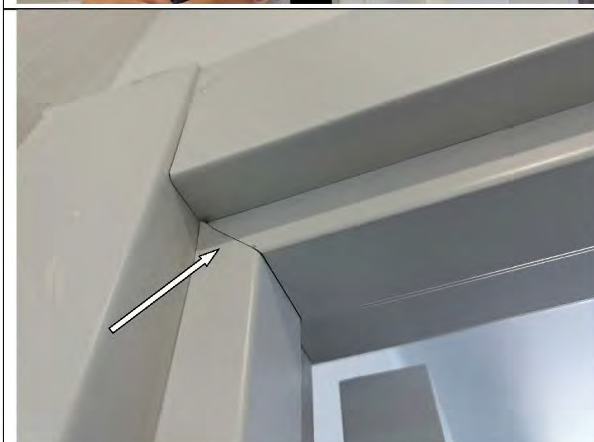
Фото №59. Элементы дверного блока в спальне соединены не надежно (коробка).
