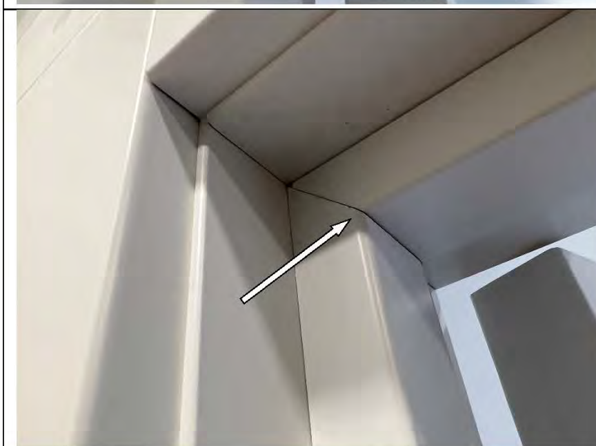
Фото №60. Элементы дверного блока в ванной комнате соединены не надежно (коробка).
