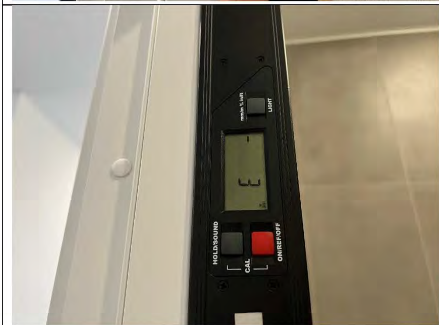
Фото №63. Отклонение коробки от плоскостности и прямолинейности дверного блока в санузле равняется 3 мм.
