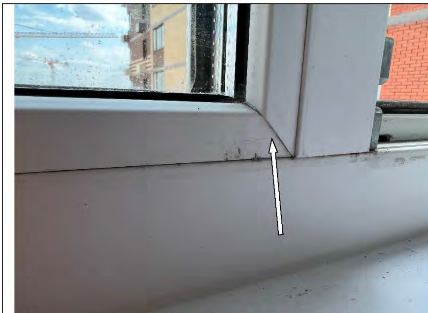
Фото №46. Зазоры в стыке профилей оконного блока ПВХ в кухне.
