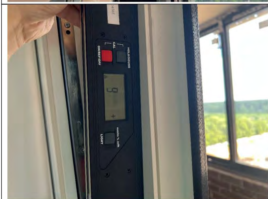
Фото №51. Отклонение коробки балконного дверного блока ПВХ в гостиной равняется 6 мм.
